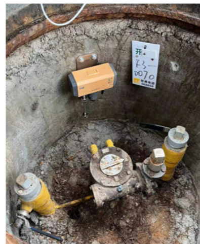
安装燃气泄露自动监测设备
