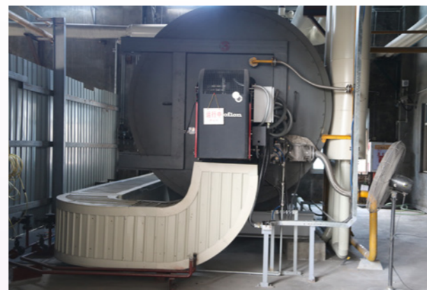
罗源县食用菌产业用上燃气锅炉，实现“煤改气”
